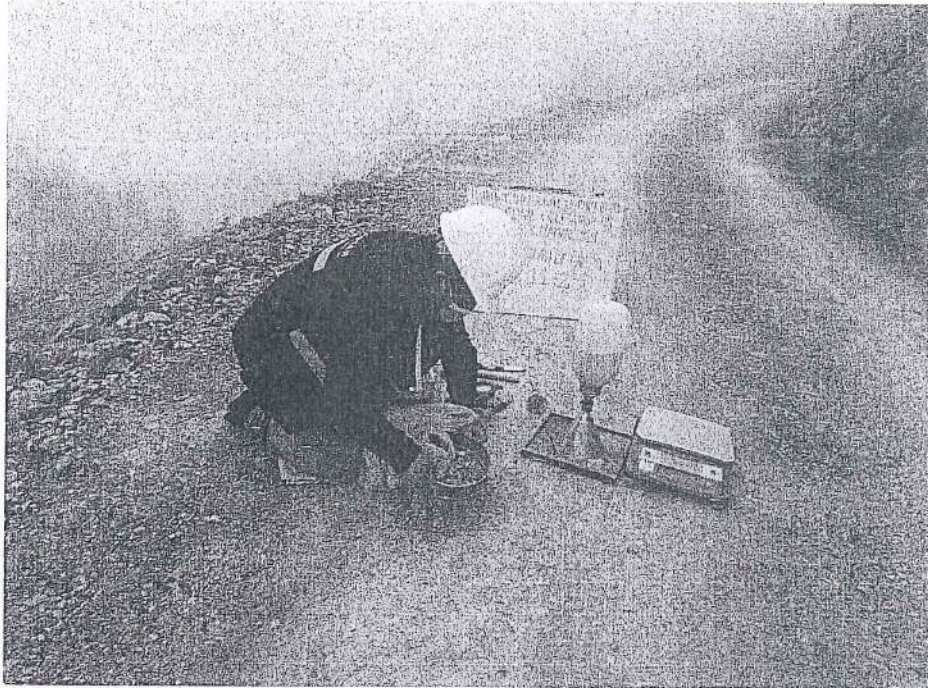
FOTOGRAFÍA N°3. Ensayo N°03 de Densidad de Suelo en Campo (Método del cono de arena) en la progresiva Km 11+250.
