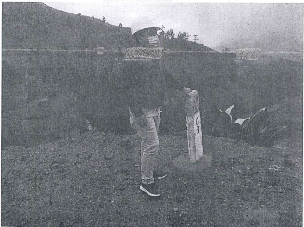
Fotografía 49. Verificación de los daños ocasionados al hito kilométrico 03 por personas ajenas a la obra .
