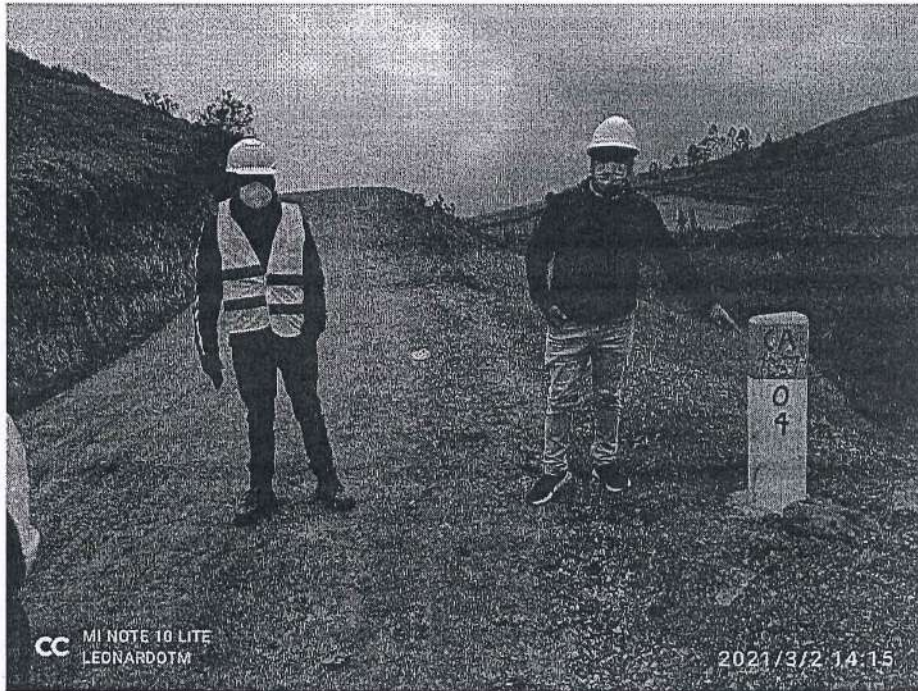
Fotografía 20. Verificación de los daños ocasionados al hito kilométrico 04 por personas ajenas a la obra .
