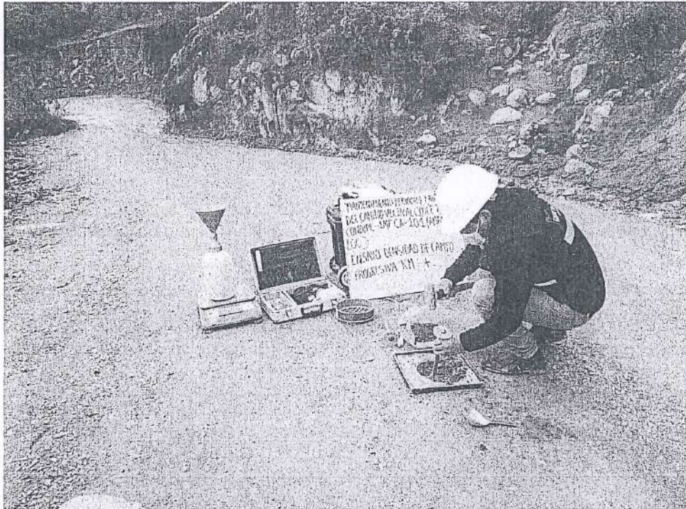
FOTOGRAFÍA N°11. Ensayo N°11 de Densidad de Suelo en Campo (Método del cono de arena) en la progresiva Km 13+250.
