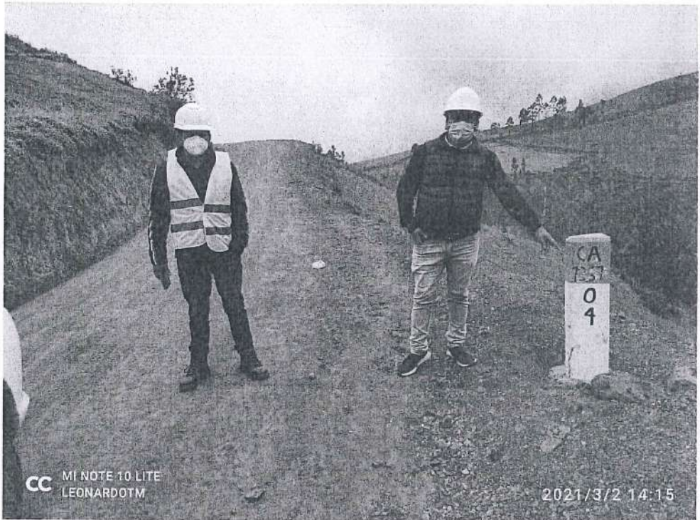
Fotografía 50. Verificación de los daños ocasionados al hito kilométrico 04 por personas ajenas a la obra .
